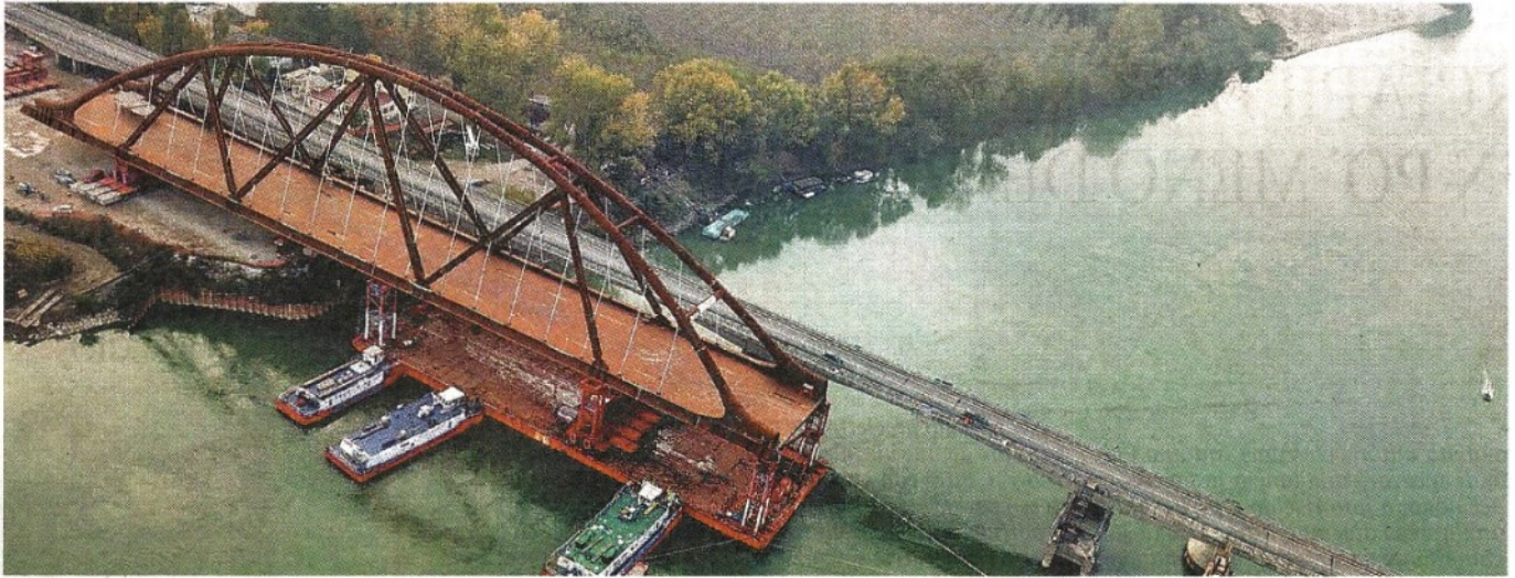
Nel Mantovano Le operazioni di varo della prima delle due campate del nuovo ponte sul Po che sostituirà la precedente struttura danneggiata dal terremoto del 2012
